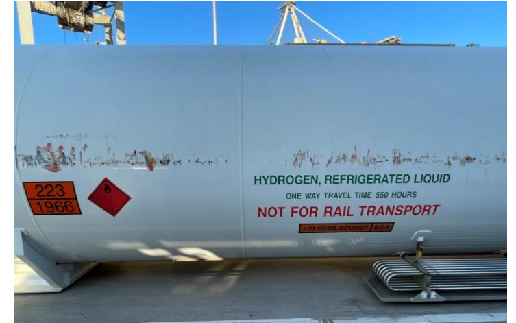
Fehlende Zulassung für Behälter
